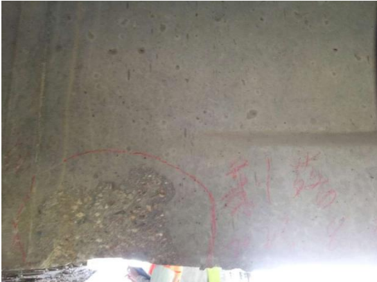
图 3-5: 枫林互通新圩特大桥(扩建)（上行）13-2T 梁: 距 13 号墩 0.3m 处, 左腹板剥落; 数量: 1 处, 长度: 0.2m, 宽度: 0.2m。
