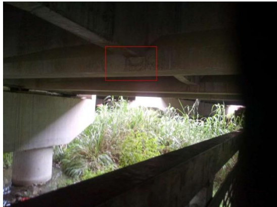
图 3-7: 枫林互通新圩特大桥(下行) 15-3T 梁: 距 15 号墩 7m 处, 马蹄左侧面破损露筋; 数量: 1 处, 长度: 0.2m。。
