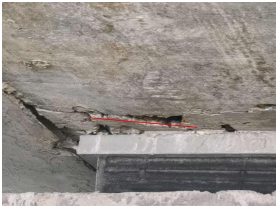
图 3-8: 枫林互通新圩特大桥(下行) 19-9T 梁: 距 18 号墩 0m 起, 左翼缘板渗水泛碱; 数量: 1 条, 长度: 0.5m, 宽度: 0.5m。
