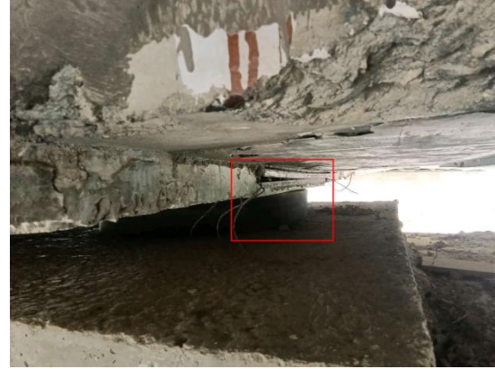
图 3-17: 过田特大桥 (下行) ZZ-1-1-4 支座: 右侧支座串动; 数量: 1 个, 位移: 0.02m。
