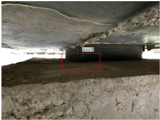
图 3-16: 过田特大桥 (上行) ZZ-13-13-4 支座: 左侧脱空; 数量: 1 个, 高度: 0.02m, 百分比: 30%。
