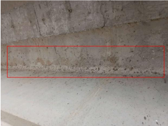
图 3-6: 过田特大桥（上行）33-5T 梁: 距 33 号墩 10m 处, 右翼缘板蜂窝、麻面; 数量: 1 处, 长度: 5m, 宽度: 0.3m。
