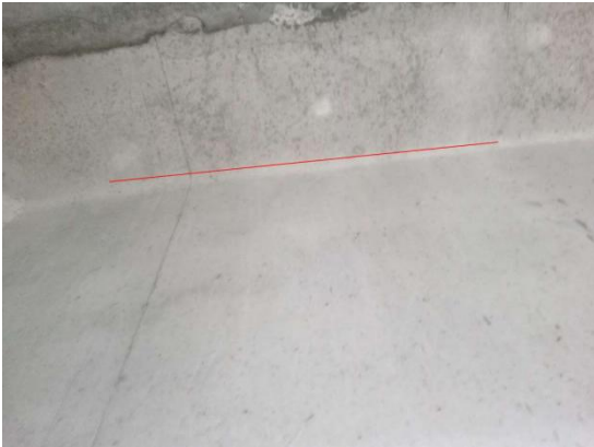
图 3-3: 际都特大桥（上行）21-4T 梁: 距 21 号墩 0m 处, 左翼缘板纵向裂缝; 长度: 2m, 宽度: 0.12mm, 数量: 1 条。
