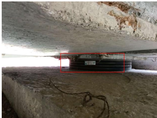
图 3-19: 枫林互通 B 匝道桥 ZZ-4-4-1 支座: 左侧横向开裂; 数量: 1 条, 长度: 0.3m, 宽度: 0.2mm。
