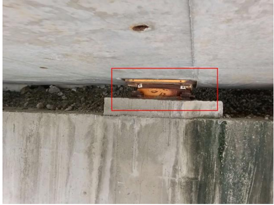
图 3-18: 过田特大桥 (下行) ZZ-17-17-1 支座: 防尘罩缺失; 数量: 1 个。
