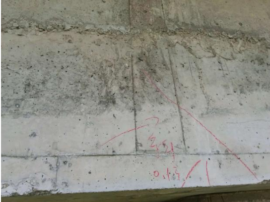
图 3-1: 枫林互通 B 匝道桥 23YFB 箱梁: 距 23 号墩 0m 处, 右腹板斜向裂缝; 数量: 1 条, 长度: 1m, 宽度: 0.13mm。
