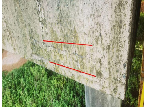
图 3-11: 枫林互通 B 匝道桥 DS-39-2D 墩身: 距上缘 0m 处, 左侧剥落; 数量: 1 处, 长度: 0.5m, 宽度: 0.5m。
