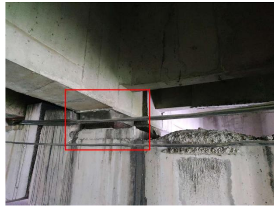
图 3-15: 枫林互通新圩特大桥(扩建) (上行) ZZ-6-6-5 支座: 左侧钢板锈蚀; 数量: 1 个。
