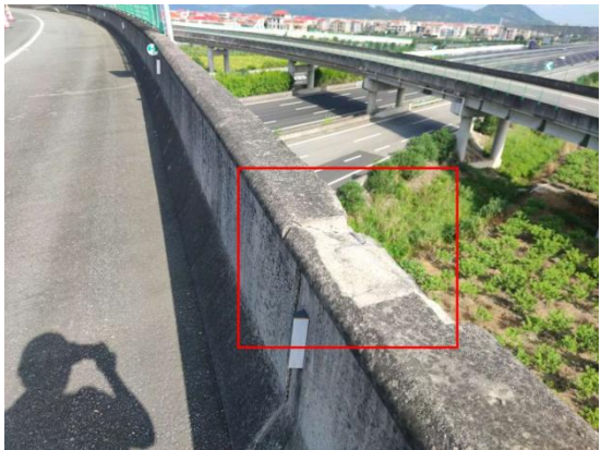
图 3-20 枫林互通 B 匝道桥 HL-R-1 右侧护栏: 右侧剥落; 数量: 1 处, 长度: 0.8m, 宽度: 0.08m。
