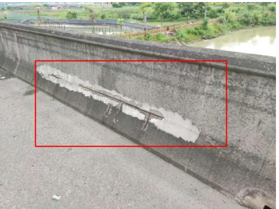
图 3-21 枫林互通新圩特大桥 (下行) HL-L-1 左侧护栏: 露筋; 数量: 11 处, 长度: 0.6m。
