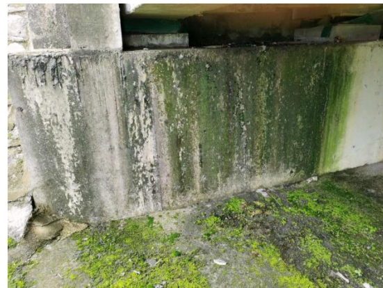
图 3-13: 枫林互通新圩特大桥(扩建) (上行) GL-14D 盖梁: 右侧挡块剥落; 数量: 1 处, 长度: 0.2m, 宽度: 0.2m。
