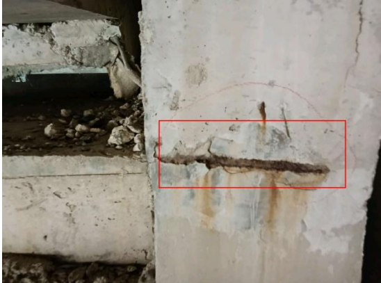
图 3-12: 枫林互通新圩特大桥(扩建)（上行）GL-12D 盖梁: 大桩号面, 左侧挡块露筋; 数量: 1 处, 长度: 0.2m。
