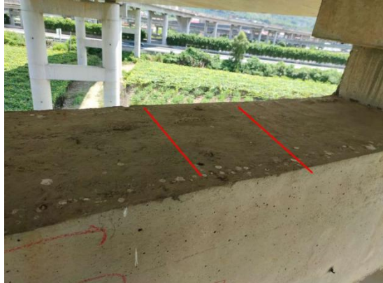
图 3-9: 枫林互通 B 匝道桥 HL-24-1D 横梁: 距右侧 3m 处, 距上缘 0m 处, 横系梁竖向裂缝; 数量: 5 条, 最大长度: 1m, 最大宽度: 0.15mm。
