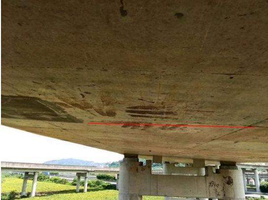
图 3-2: 枫林互通 B 匝道桥 25DIB 箱梁: 距 24 号墩 9m 处, 距右侧 0.5m 起, 梁底横向裂缝; 数量: 1 条, 长度: 4m, 宽度: 0.14mm。
