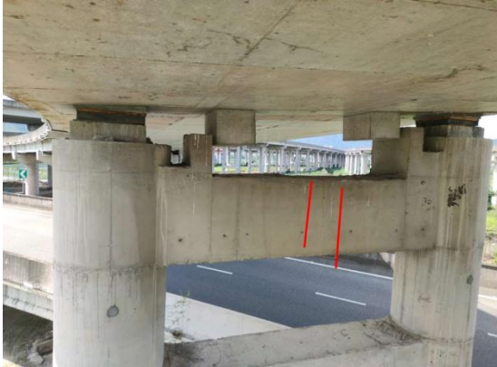
图 3-10: 枫林互通 B 匝道桥 HL-25-1D 横梁: 小桩号距左侧 3m 处, 距上缘 0m 处, 横系梁竖向裂缝; 数量: 1 条, 长度: 1m, 宽度: 0.15mm。
