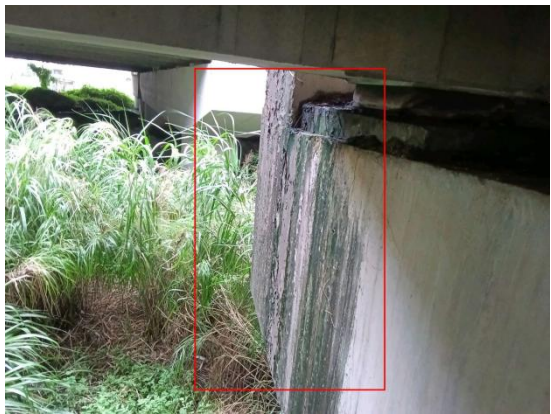
图 3-14: 枫林互通新圩特大桥(下行) GL-16D 盖梁: 受水侵蚀。
